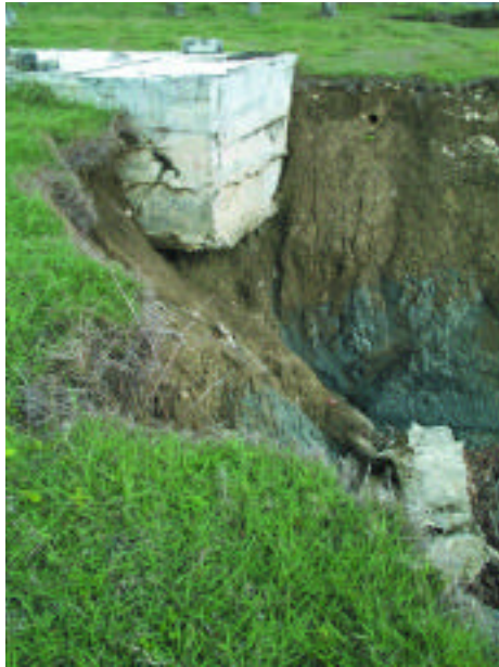
Figura 7. Escarpe acantilado ubicado 200m al sur de Arboletes. El retroceso de estos escarpes fue inducido también en parte por filtraciones de los tanques de almacenamiento de aguas.
